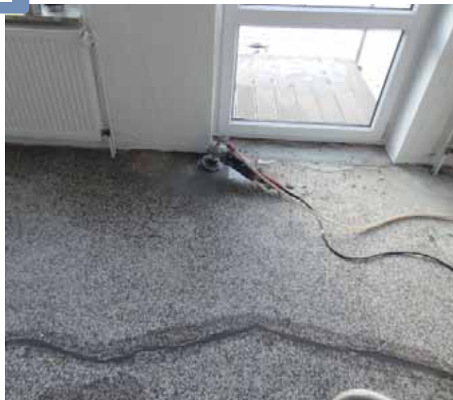
Risse, Fehlstellen und Flecken sind typische Schadensbilder an Terrazzobelägen.
