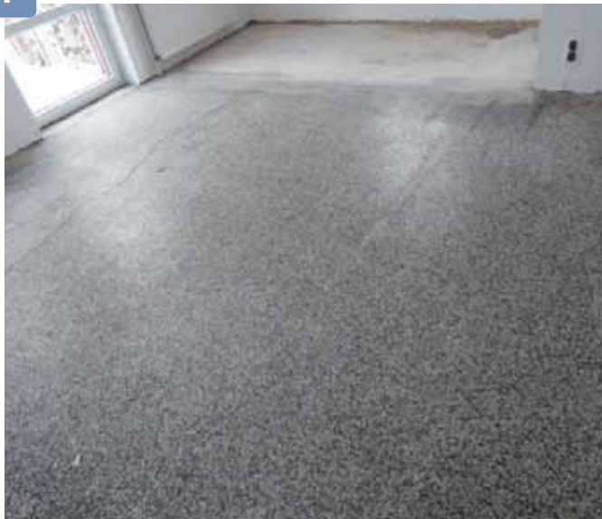
Nach vielen Jahren ist der Belag immer noch gebrauchstüchtig, aber nicht mehr ansehnlich.
